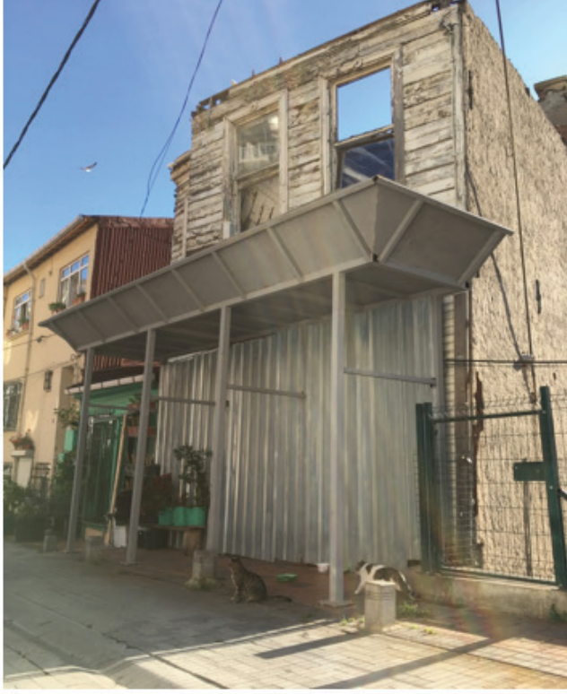
Arnavutköy Mahallesi Girgin Sokak No: 65 Güvenlik Önlemi Alındı
