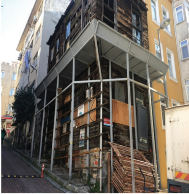
Türkali Mahallesi Mecit Ali Sokak No:1 Güvenlik Önlemi Alındı
