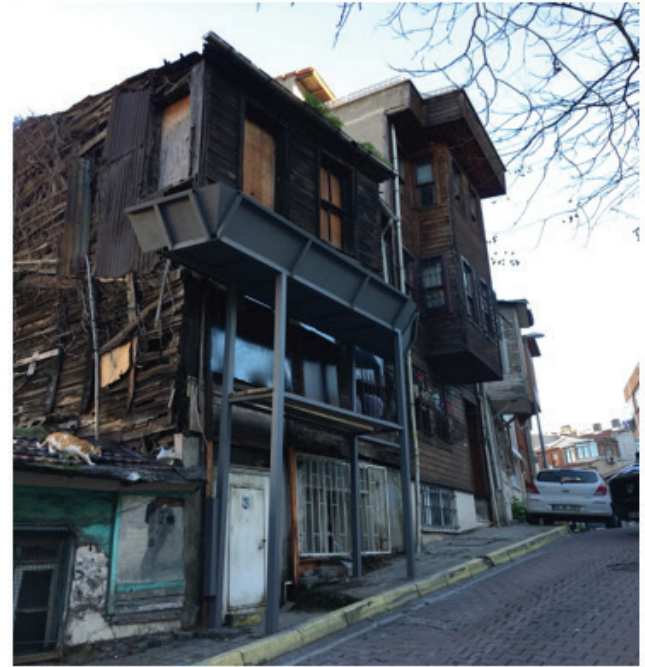
Vişnezade Mahallesi Çatlak Çeşme Sokak No:28 Güvenlik Önlemi Alındı
